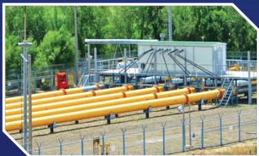
Система телемеханики Магистральных Газопроводов ООО «Газпром трансгаз Нижний Новгород»
